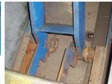
グリスが完全に乾ききって錆ている状態
