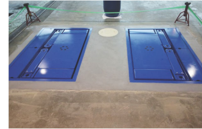
リフト上部は、床の中にスッキリ納まった状態で停止します。
