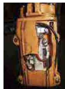
▲破損したスイッチ
