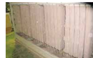
稼動し粉じんが 集積された状態
